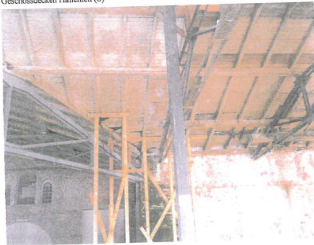
Stark geschädigter Dachbereich Hallenecke 5/2/4 mit Notabstützungen Folgt Seite: 7
