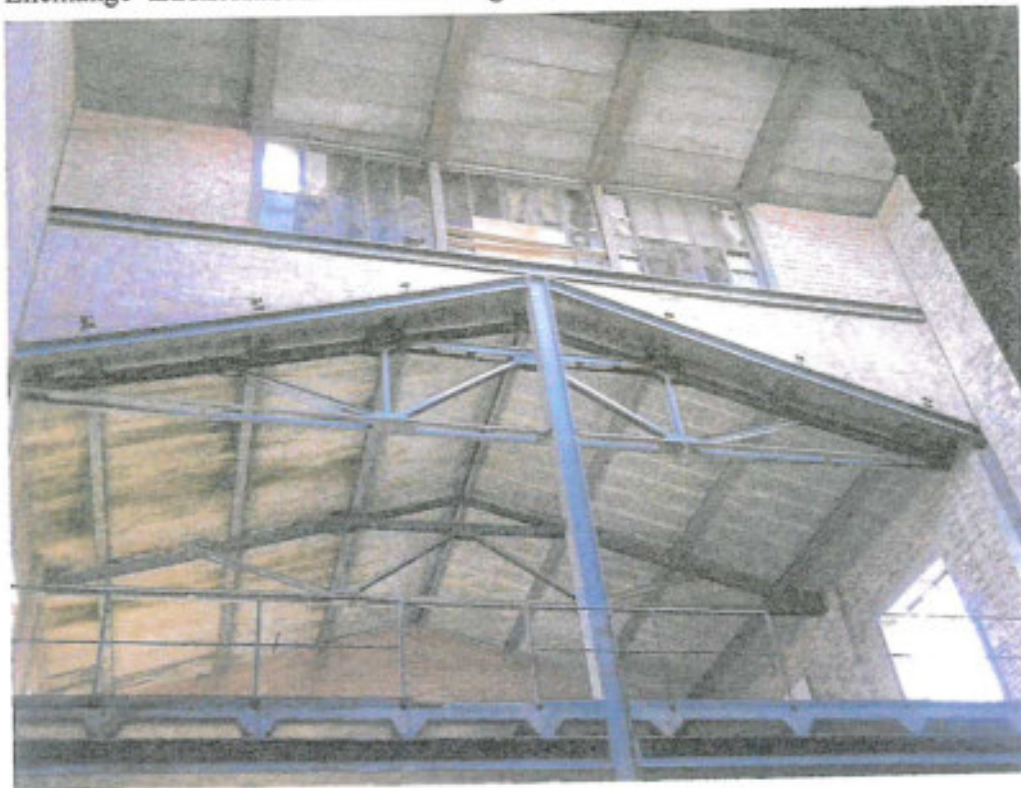
Dachaufsatz u. Dach Hallenteil (1) mit starker Durchfeuchtung
