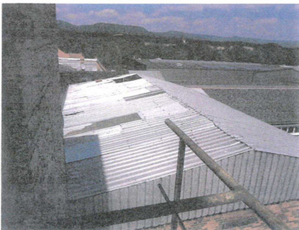
Fehlende Dachplatte auf östlicher Nachbarhalle
